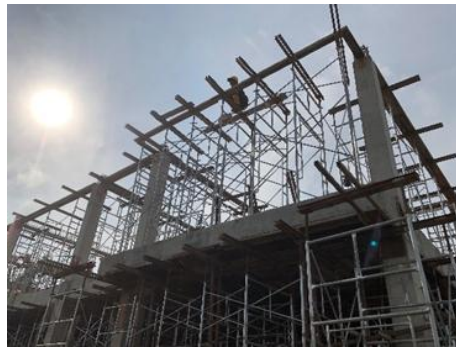
Gambar 2. Pekerja Tidak Menggunakan Body Harness Pada Pekerjaan di Ketinggian Sumber: Dokumentasi pribadi
