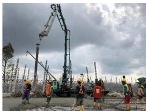
Gambar 16. Pekerja Tidak Menggunakan APD Lengkap Saat Pengecoran Sumber: Dokumentasi Pribadi
