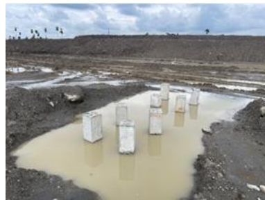
Gambar 20. Genangan Air Pada Galian Pile Cap Akibat Hujan Sumber: Dokumentasi Pribadi
