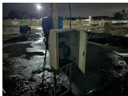
Gambar 14. Tidak Adanya Rambu Bahaya Listrik Pada Area dengan Potensi Bahaya Listrik Sumber: Dokumentasi Pribadi
